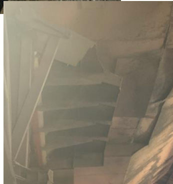
可動フード損傷
